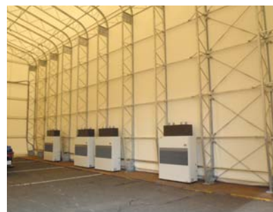
●空調設備(冷暖房)
